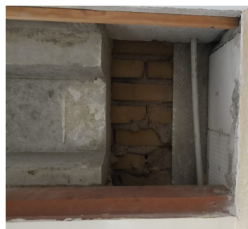
Op de foto rechts is te zien dat tussen de gipsblokken muur van de woonkamer en de bakstenen buitenmuur een plaat is aangebracht. Dit is waarschijnlijk een Eternit asbestcement plaat
